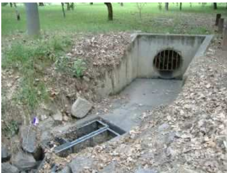
9.attēls. Lietusgāzēm adaptētu „slazdu” izbūve ļauj pārtvert eitrofikāciju veicinošo neattīrīto lietus notekūdeņu pārtveršanu
